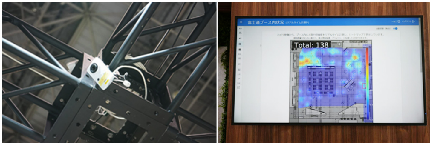
画面左：天井に設置されたAIカメラ
