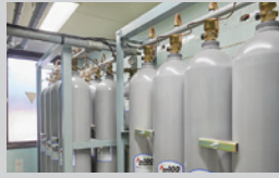
B 消火設備 サーバー機器を汚損しない 窒素ガス消火設備を完備。
