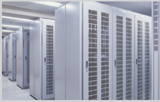
A サーバルーム 鹿児島最大級のデータセンター
