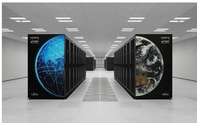
第11世代スーパーコンピュータシステム（注8）
