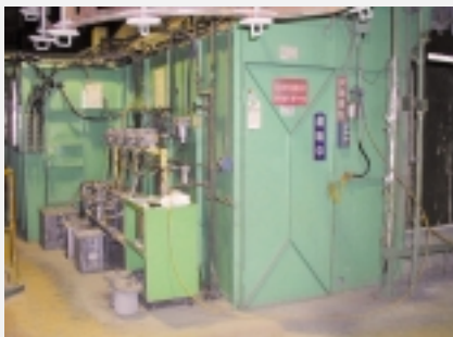
溶剤回収装置(明石工場)
