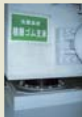
免震装置 (積層ゴム支承)
