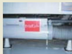
免震装置(オイルダンパー)
