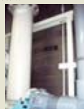
フッ素2次処理装置
