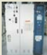
PFC除害装置
